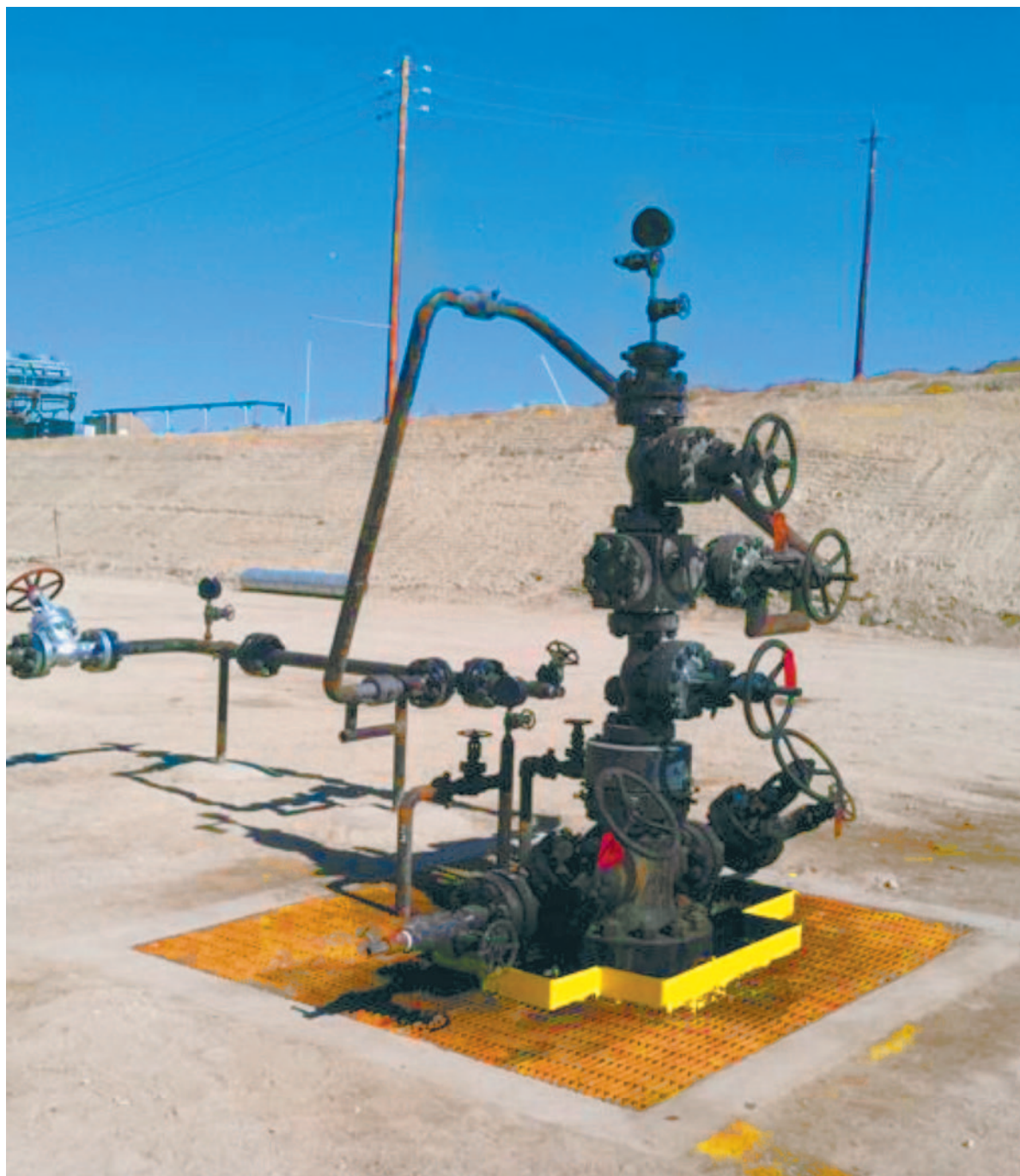
Cabezal de inyección de vapor en Bakersfield, California.
